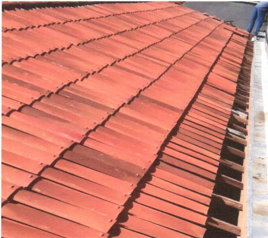
FOTO 18 – Retelhameto em cobertura com telha ceramica tipo canal comum, Itabaiana ou similar.
