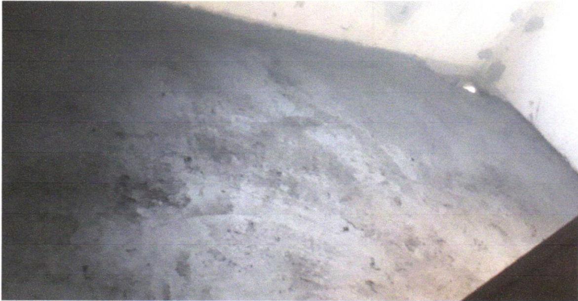
FOTO 09 – Contrapiso em argamassa traço 1:4 (cimento e areia), preparo mecânico com betoneira 400 l, aplicado em áreas secas sobre laje, não aderido, acabamento não reforçado, espessura 5cm. af_07/2021
