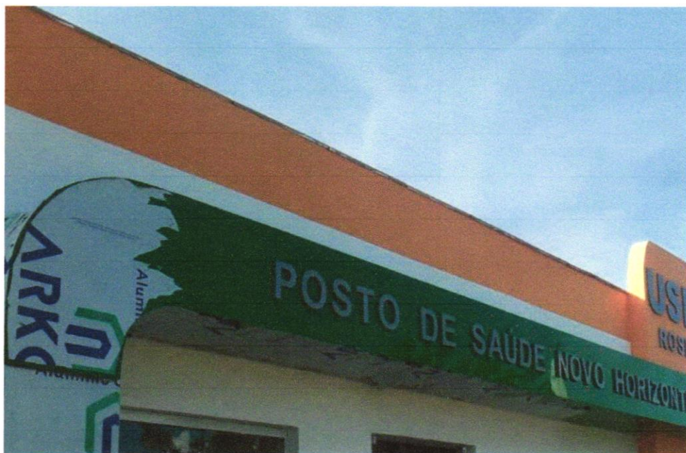
FOTO 02 – Chapim de concreto pré-moldado
